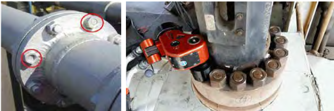
Fig. 1.7.47 Insufficient stud bolt length
