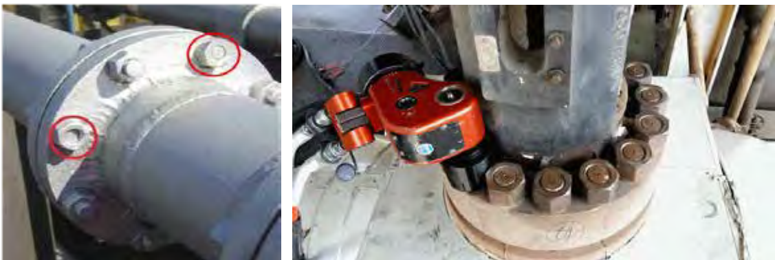
Fig. 1.7.47 Insufficient stud bolt length
