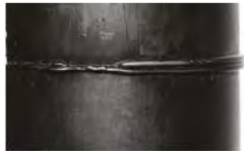
Fig. 2.5.20 Unacceptable butt fusion
